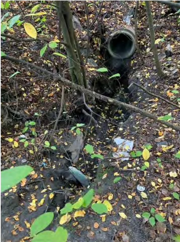
Figur 5 – Bild som visar utloppsledningen till befintligt dike. Urspolning av material pga. högt flöde kan ses i bilden. Avstånd från lägsta punkten i det urspolade hålet i marken till utloppsledningens övre nivå är ca 1,6 meter. Bild från platsbesöket.
