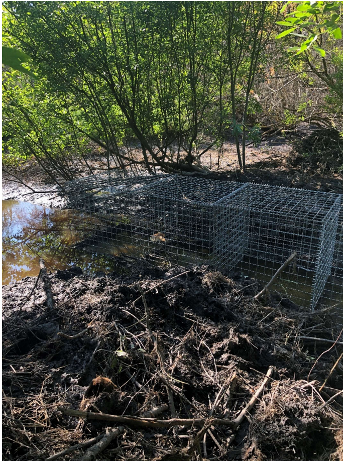
Figur 19. Fyra gabionburar har kopplats ihop och placerats på tvären i ett bäverdämme på den nivå som vattnet kan tillåtas att gå upp till. På detta sätt har vattennivån sänkts så pass mycket att en fastighet nu slipper översvämningar i källaren som hade skapats av dämnet.
